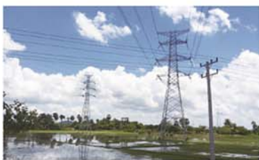
柬埔寨金边环网输变电工程
